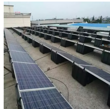
148kw on Hongkong
